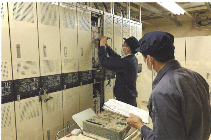
防災行政無線の設備点検
